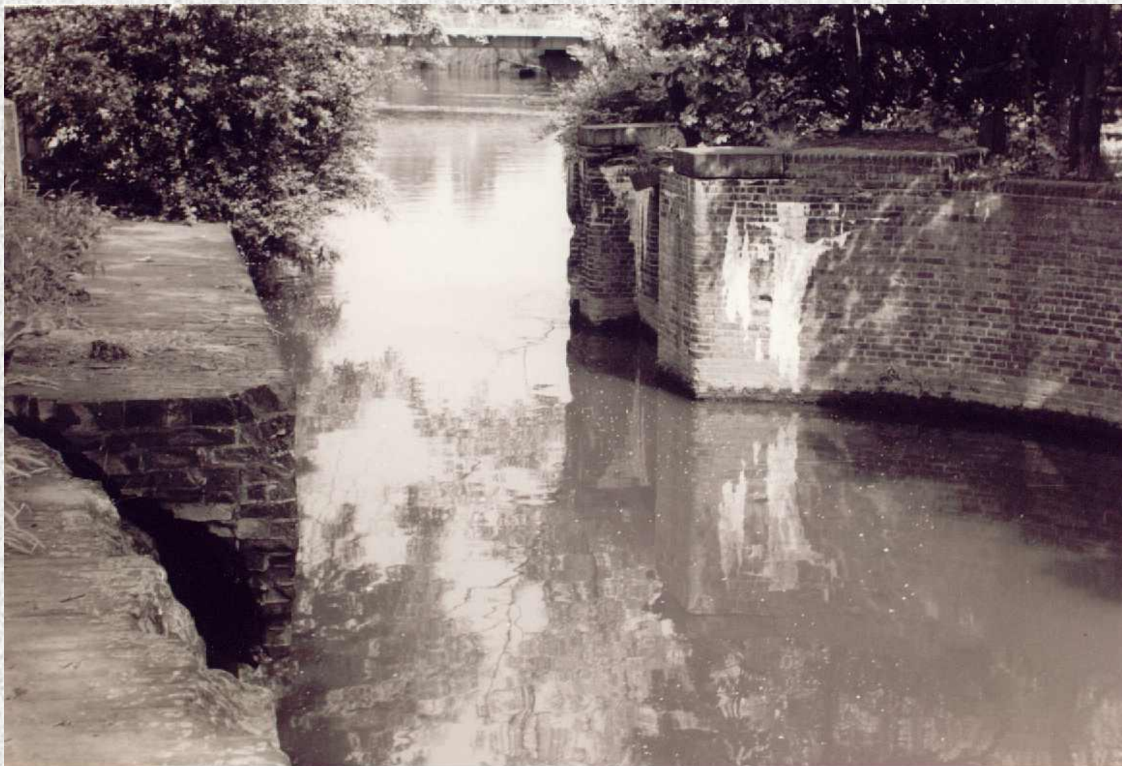
Śluza Mieszkańska – przed remontem
