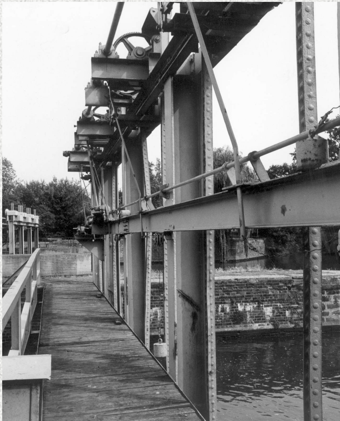
Elektrownia wodna Wrocław Południe. Jazy klapowe, 1922-1924
