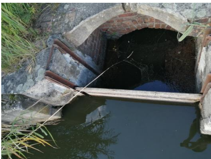
Podstawowe urządzenie piętrzące stawów: podwójny rząd szandorów drewnianych w prowadnicach stalowych, tu: przed ceglany, sklepionym przepustem wałowym.
